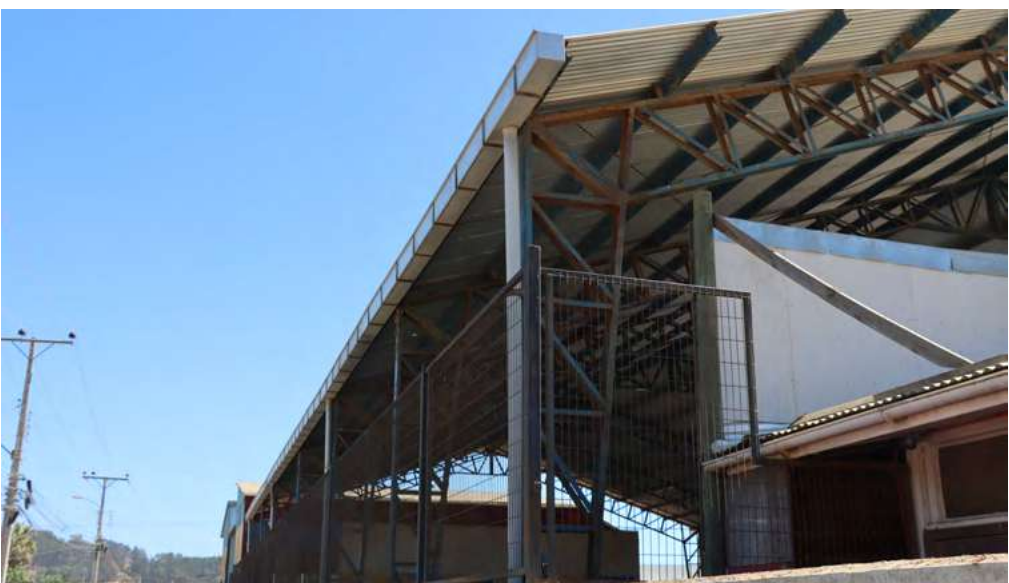
Canalización aguas lluvias – $752.890 (Municipio).
