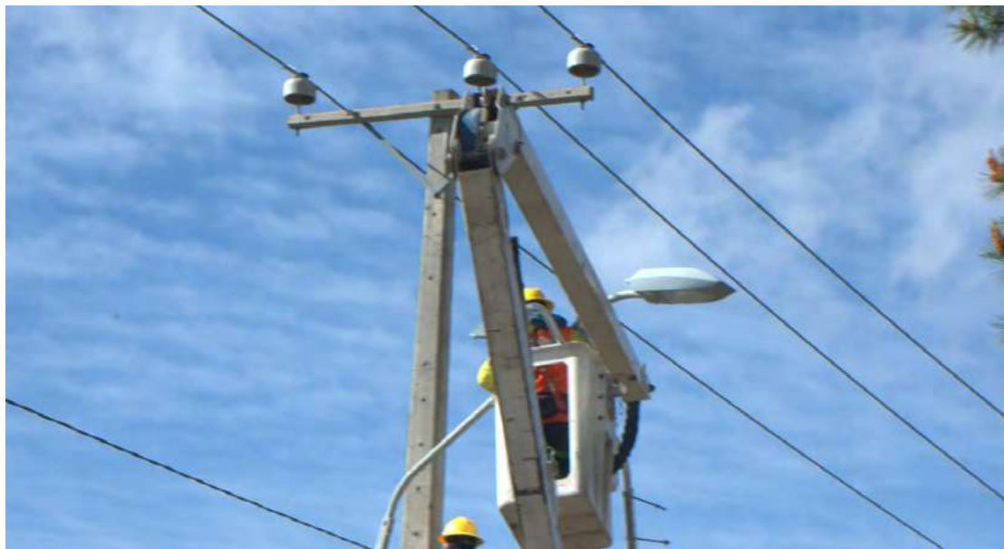
Mejoramiento del alumbrado público en Cardonal de Panilonco y La Aguada
